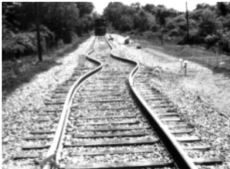
FIGURE 1.1 – Flambage de rails sous l'effet de la dilatation thermique
