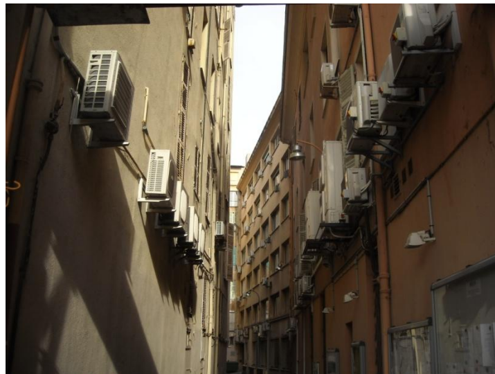
Figure 1. 17 : Impasse de Nice où chaque appartement est équipé d'un climatiseur mono-split (janvier 2013)
