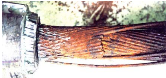
(d) Ruptures de fatigue toron multicouche
