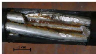
FIG. 3.14 – Rupture d'un sur sept fils d'un mono-toron
