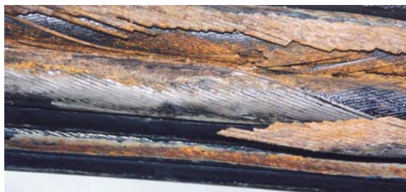
(e) Cas de fretting fatigue frottements torons / torons.
