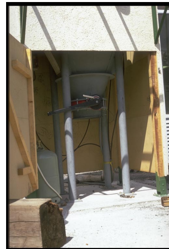
Figure 75: Vue de la partie inférieure du filtre à manches.
