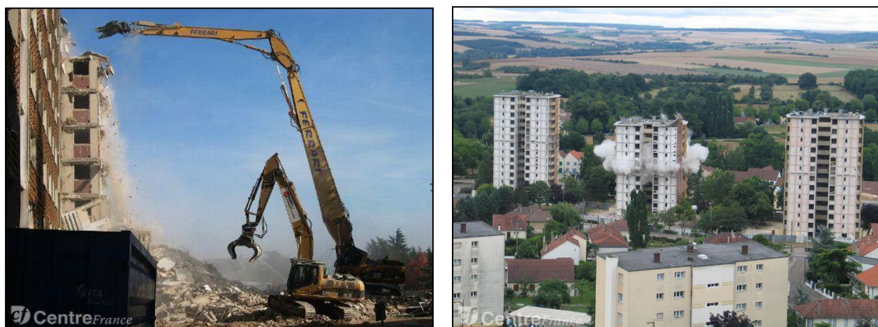
Figure 69 : Démolition de l'immeuble Porche à Sainte Geneviève et des tours des Brichères en juin 2007
