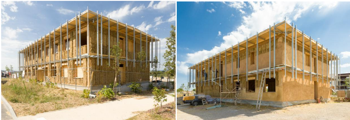
Figure 91 : Mise en œuvre de la paille (à gauche) puis couverture par l'enduit à la chaux (à droite)
