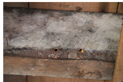
(c) Trous dans une poutre en béton
