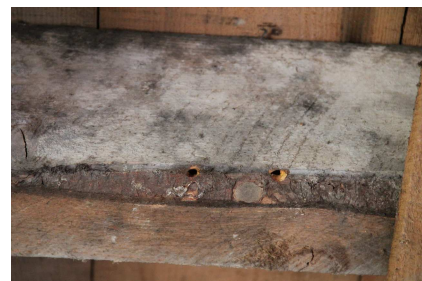
(c) Trous dans une poutre en béton
