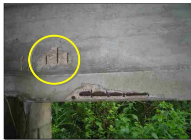
(b) Fissuration d'une poutre et écartement du béton
