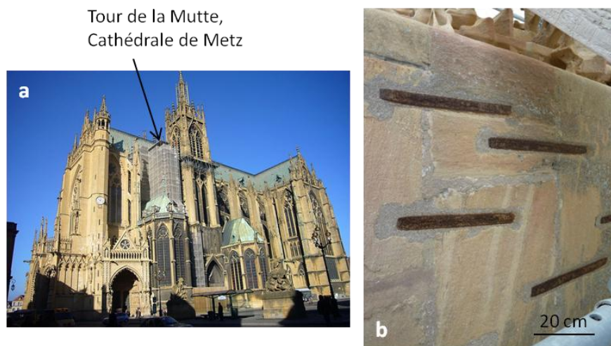
figure 29 : a : Cathédrale Saint-Étienne de Metz (source : wikipédia). b : agrafes de renfort en alliage ferreux, encore en place à l'extérieur de la tour de la Mutte.
