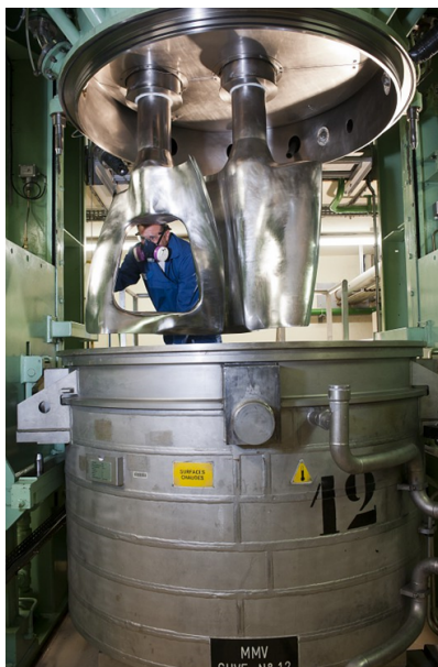
Figure 1.5: Phase de malaxage d'un chargement de propergol dans une cuve (d'après le site internet de SAFRAN HERAKLES)
