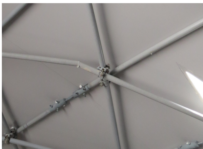
Figure 2.66 - Rupture de tube dans la nappe inférieure
