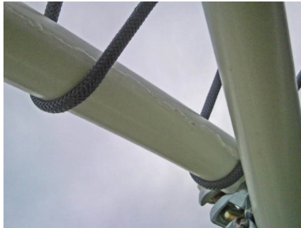
Figure 2.38 - Endommagement d'une rive située au niveau d'une porte
