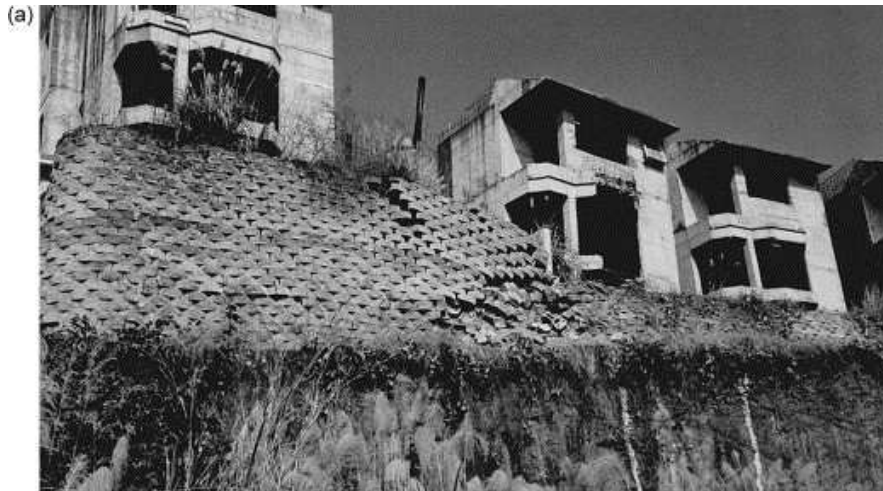
Figure 1-24 : Rupture d'un remblai renforcé par des géotextiles lors du séisme Ji-Ji [LIN01a]
