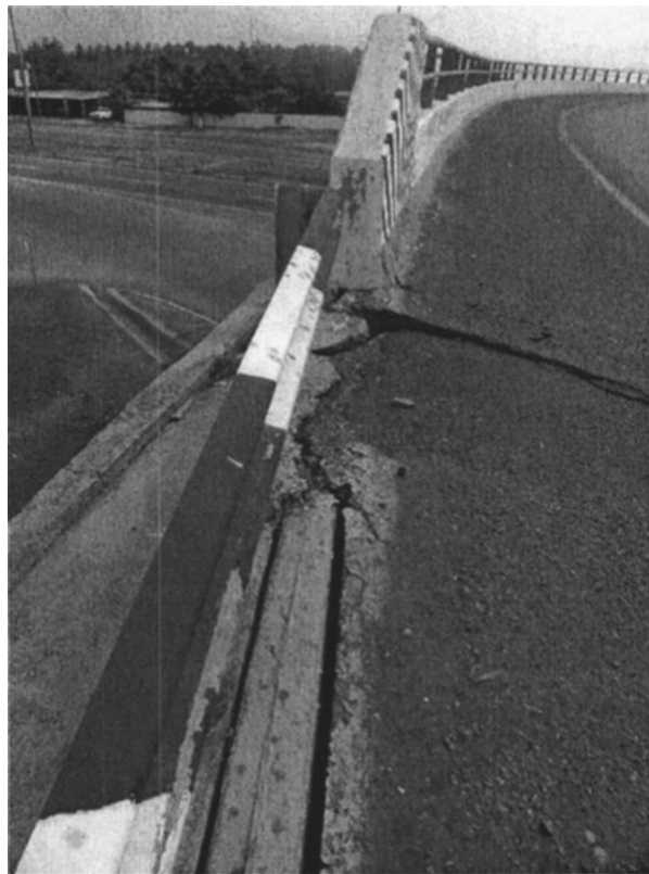
Figure 1-25 : Fissures provoquées par le déplacement horizontal d'un remblai en Terre Armée au cours d'un séisme [WAR06]
