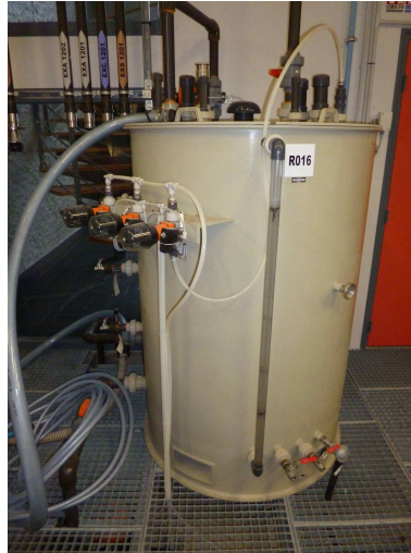
Figure 26 : Cuve de 1 m3 pour la récupération d'eau issue de la laverie et de douches
