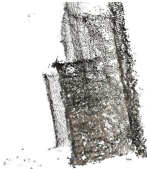
Figure 75 : Sur ce nuage de points, les trous dans les parties des contreforts peuvent provoquer des erreurs de correspondances
