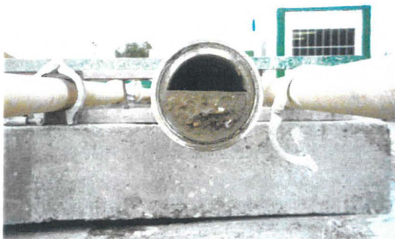
Figure V.7 – Ségrégation du béton dans la tuyauterie.
