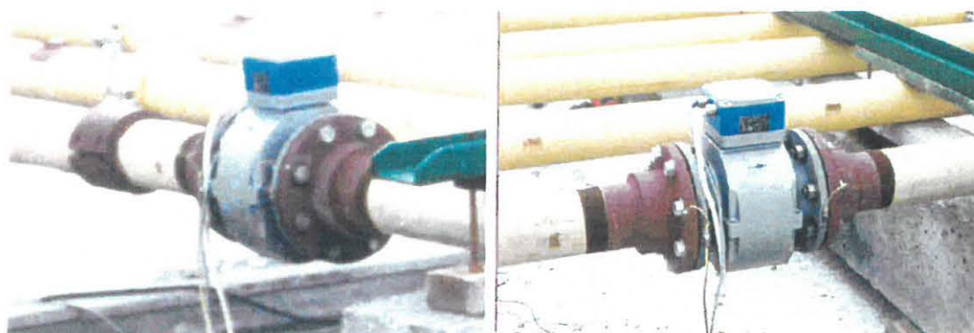
Figure IV.11 – Vue du débitmètre à béton branché sur le circuit.
