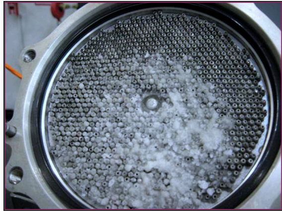
FIGURE 1.5 – Entrée de l'échangeur de chaleur du Trent 800 obstrué par de la glace lors de l'enquête [185].
