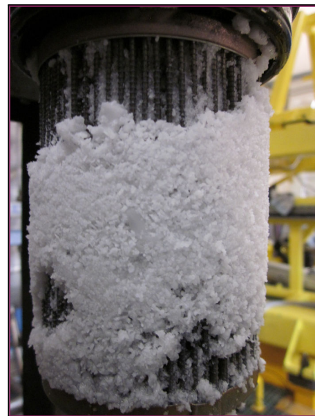
FIGURE 9.14 – Dépôt de glace sur un élément filtrant.
