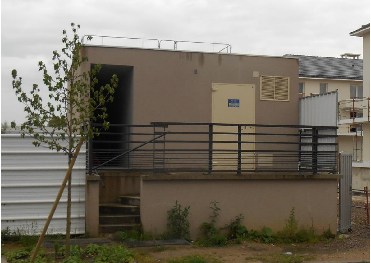
Figure 57 Un transformateur électrique dans Parc-en-Seine, Villeneuve-le-Roi Source : Adeline Dupont, 05/2014
