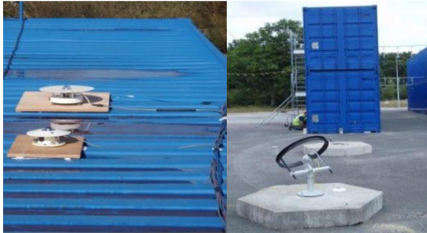
(a) Sur les toits des conteneurs. (b) Pyranomètre isolé.
