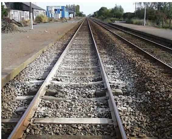
Figure I.16 : Photo d'une zone de remontée boueuse
