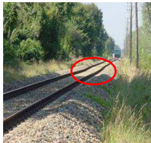
Figure I.17 : Photo d'une zone de défaut de portance
