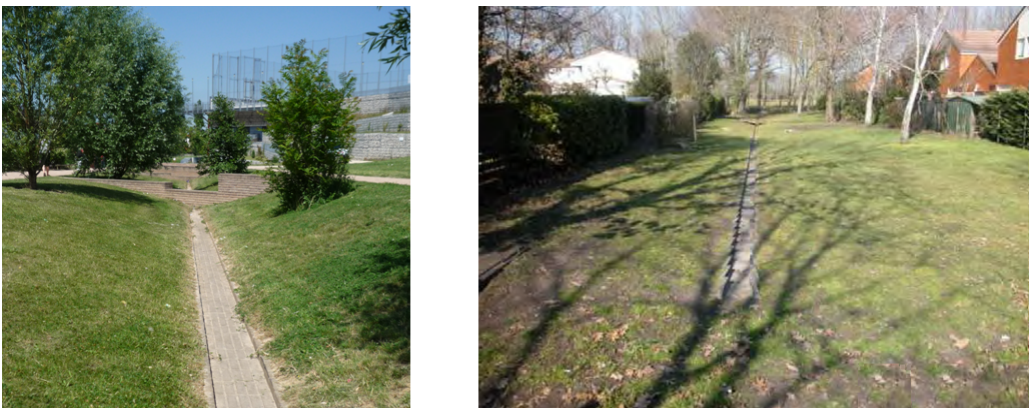
Figure 1.12 – Exemples d'ouvrages de type noues équipés de cunettes: à gauche à Chenevieux, (source : M-C. Gromaire), à droite, à Bruges (d'après CUB, 2014)
