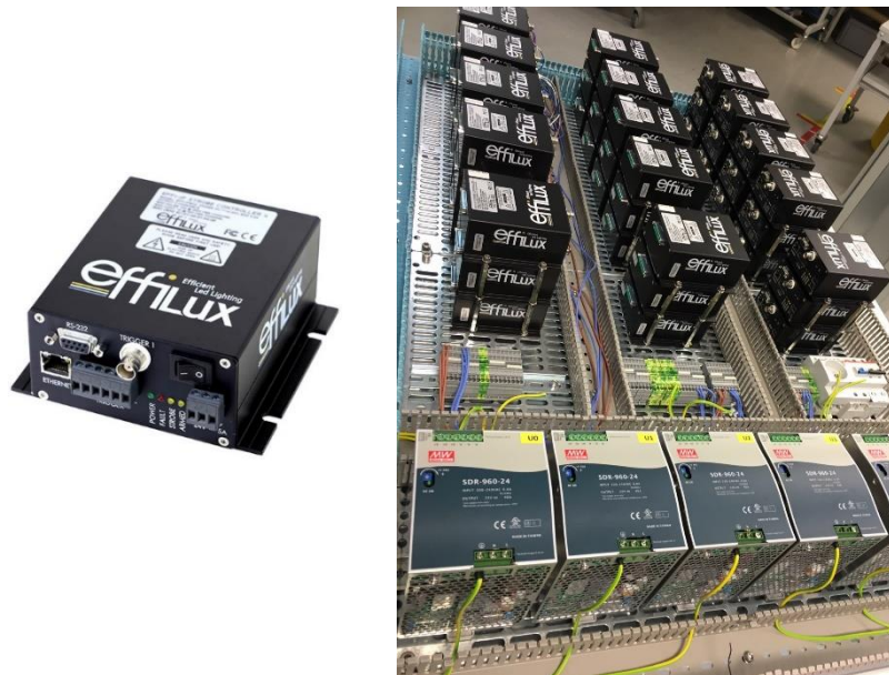
Figure IV-14 : Photos d'un contrôleur et de l'armoire électrique, en cours de montage.
