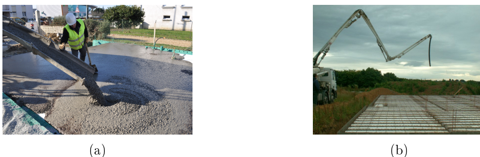
Figure 0.1 – Photos d’opérations de (a) coulage et de (b) pompage lors de la mise en place de béton.
