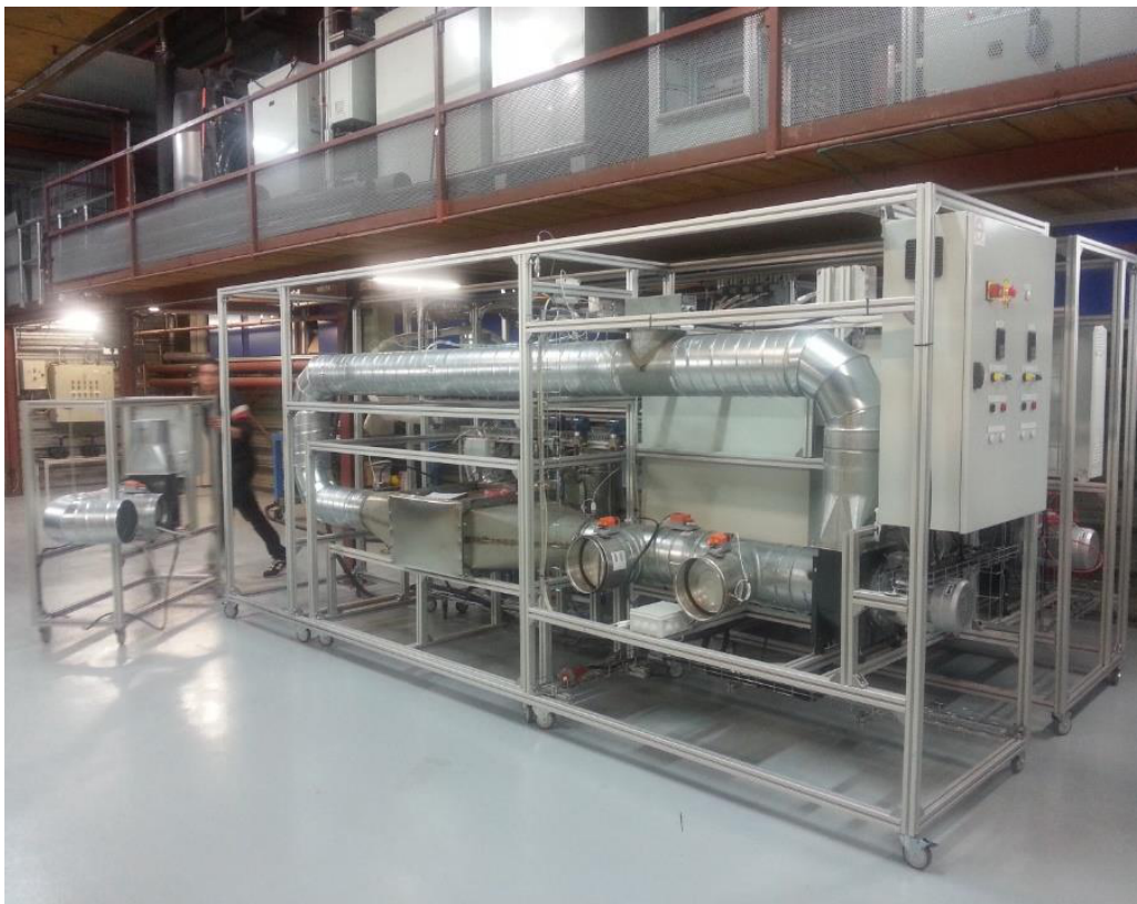
Figure 4.15: Photographie du banc d'essai côté boucle aéraulique chaude. Sont visibles, les deux ventilateurs et une armoire de contrôle à droite, le refroidisseur de gaz, le système de registre permettant de contrôler la température de retour d'air et une résistance chauffante au centre.
