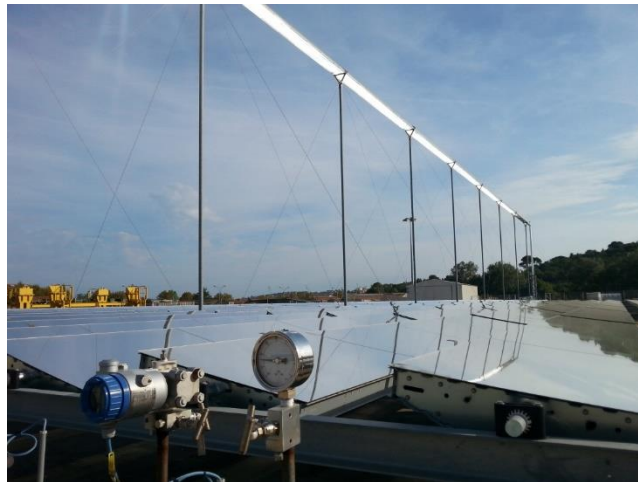
Figure I-3 : Installation de conversion thermique du rayonnement solaire sur le site de la CNIM à La Seyne sur Mer dans le Var (Crédit : Roseline Adde-Wald).
