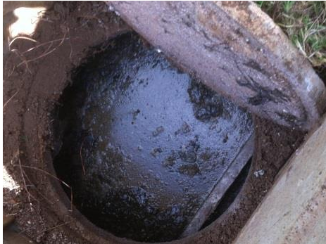
Fosse « toutes eaux »
