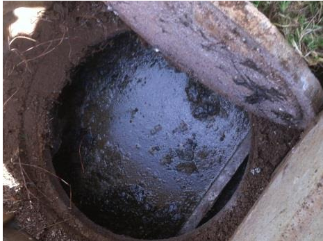
Fosse « toutes eaux »
