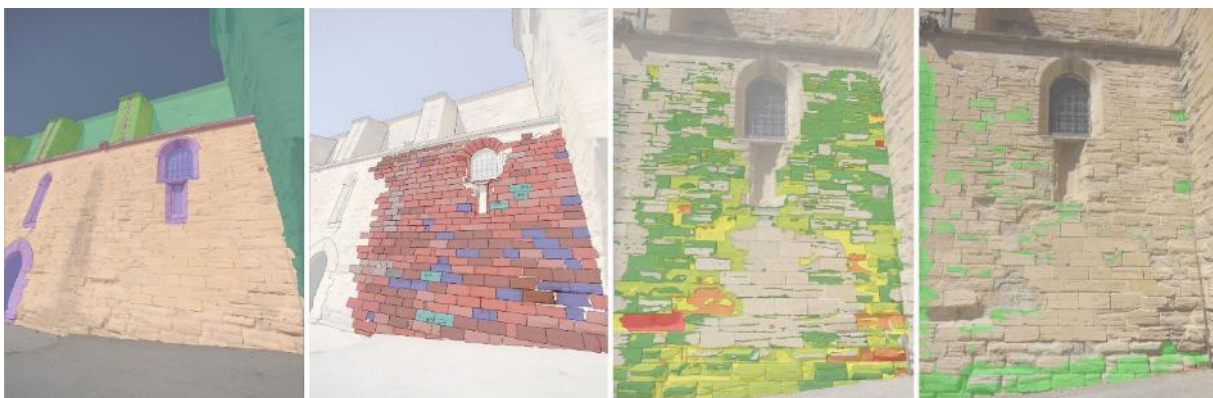
Figure 129 : Cartographies manuelles de gauche à droite : composants architecturaux, matériau bloc à bloc, perte de matière, et colonisation biologique, partie de la façade Est de l'église Saint Maurice. [Benard A., 2015].
