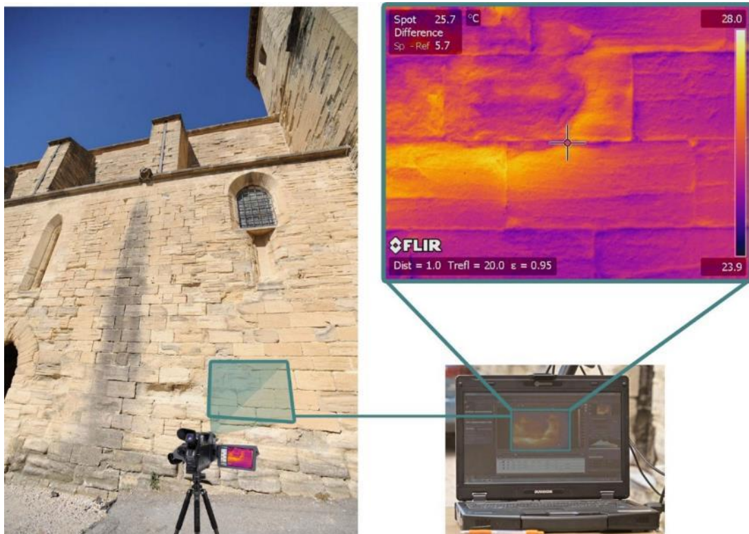
Figure 19 : Contextualisation de l'utilisation de la thermographie IR (passive), résultat en haut à droite d'un point de vue sur une altération : façade Est de l'église Saint Maurice (CICRP.données Vallet J. M.).
