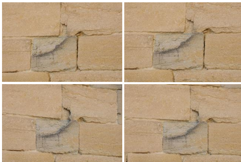
Figure 14 : Exemple de détail sur le mur Est de l'église de Caromb, sous plusieurs angles de prise de vue.
