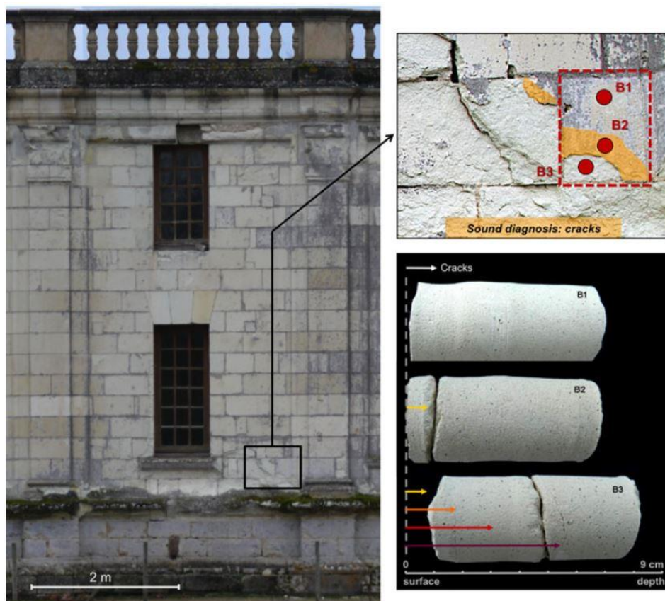
Figure 27 : Exemple d'échantillonnage pour l'analyse de la desquamation en plaque, montrant la position des échantillons et les trois états du processus d'avancement de la dégradation (à droite) [Janvier-Badosa S. et al., 2014].
