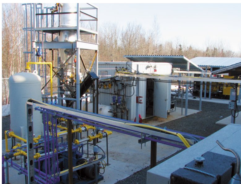
Figure 1.6 – Installation test d'Atlantic Hydrogen à Fredericton dans la province du New Brunswick (Canada)
