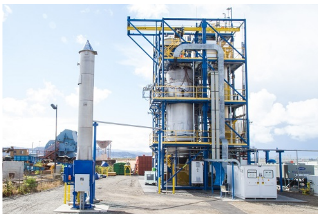
(a) Installation pilote à Redwood en Californie (USA)
