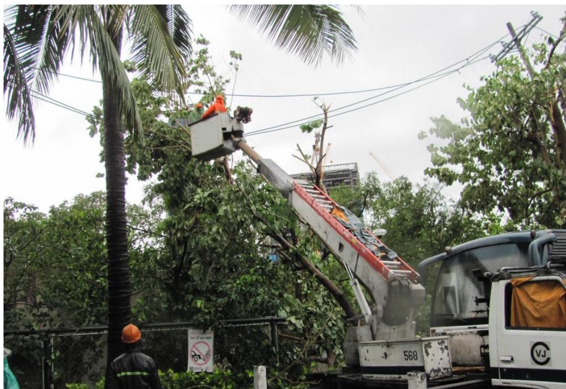
FIGURE 6.6 – Les restauration du service électrique suite au passage du typhon Glenda à Quezon City, en juillet 2014.
