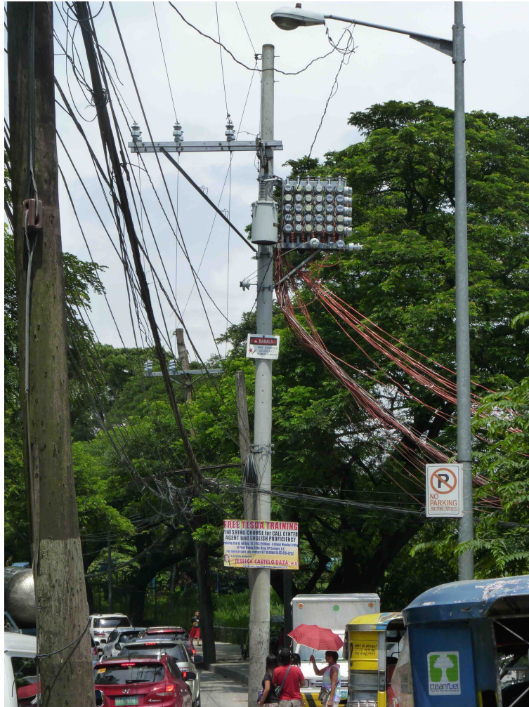
FIGURE 5.3 – Une « grappe » surélevée de compteurs électriques à Quezon City. Les câbles oranges sont « anti-sabotage » : on ne peut s’y connecter à l’aide d’un simple branchement. Source : photographie personnelle (2015).
