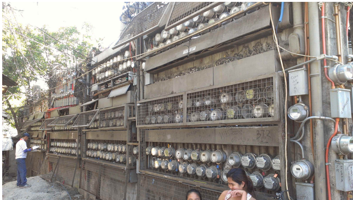
FIGURE 5.1 – Un « mur de compteurs électriques » dans le quartier de Pansol, à Quezon City. Source : Photographie personnelle (2013).
