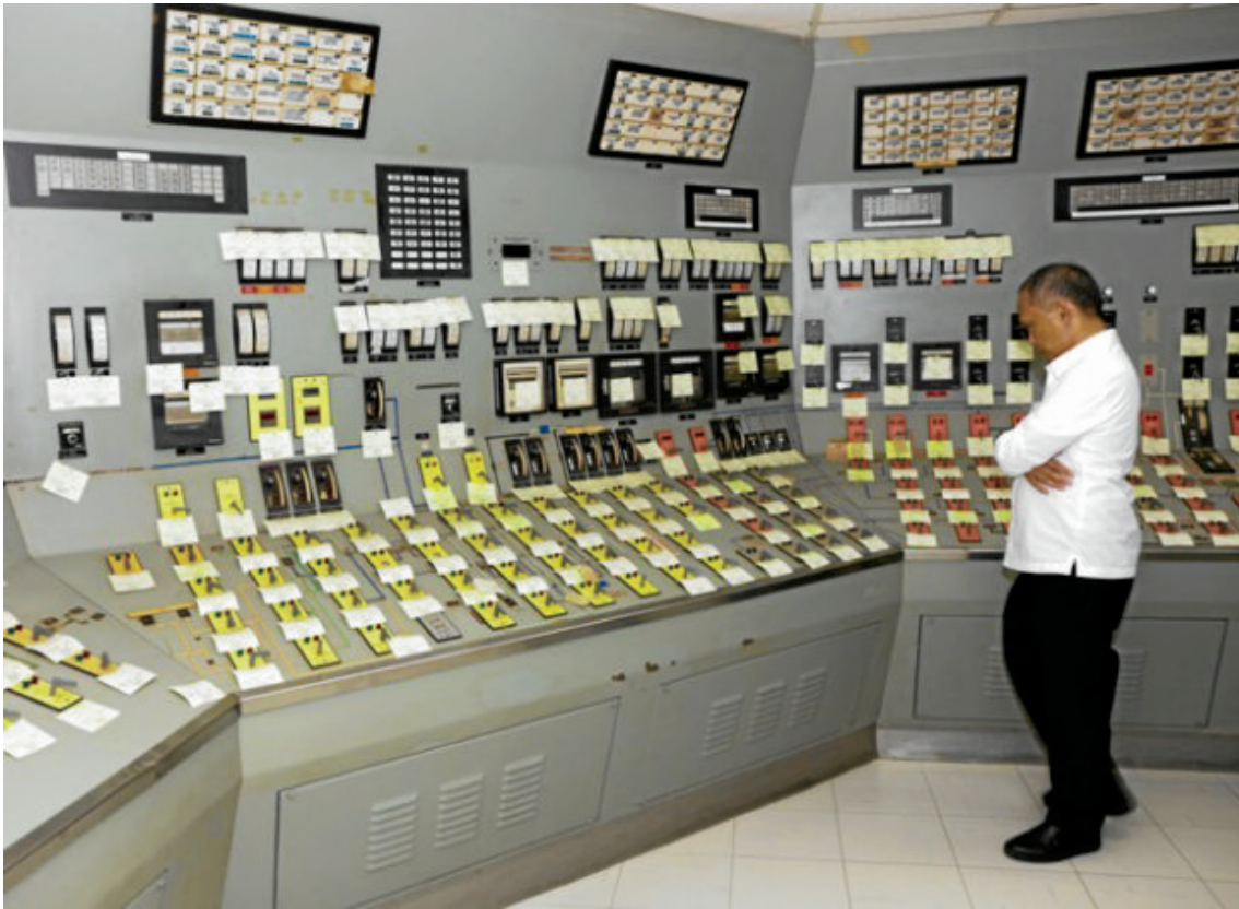
FIGURE 1 – Le secrétaire à l'énergie Alfonso Cusi dans la salle de contrôle de la centrale nucléaire de Bataan. Les boutons et indicateurs, jamais utilisés, sont scellés et étiquetés en attendant une hypothétique mise en fonctionnement des installations.
