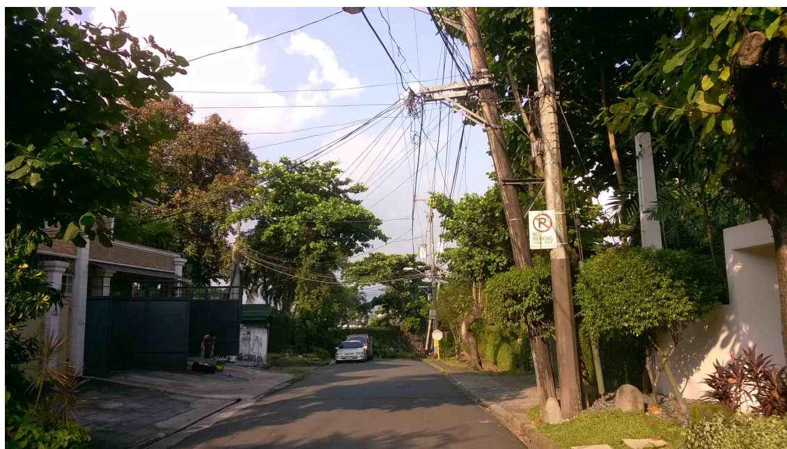
FIGURE 6.7 – Lacis de câbles électriques suspendus au-dessus des rues du lotissement (aisé) Blue Ridge A. On note que l'un des poteaux électriques est en bois, et l'autre en béton. Source : Mouton (automne 2015).
