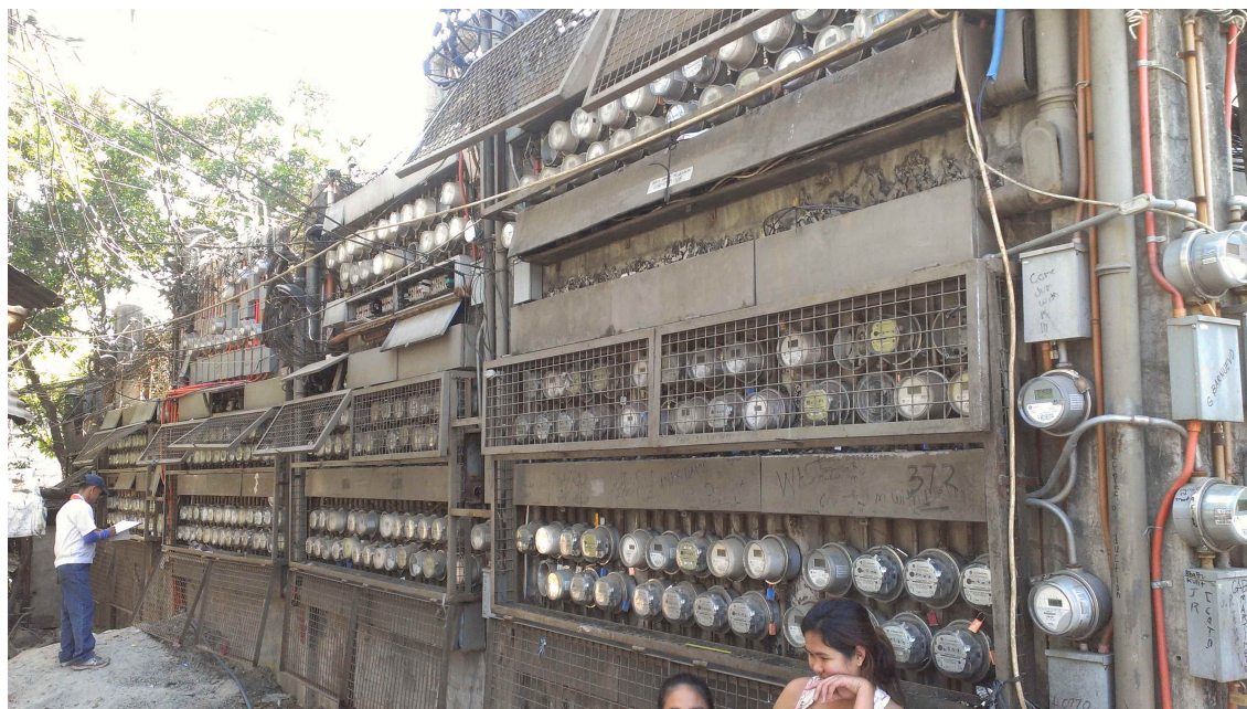
FIGURE 5.1 – Un « mur de compteurs électriques » dans le quartier de Pansol, à Quezon City. Source : Photographie personnelle (2013).
