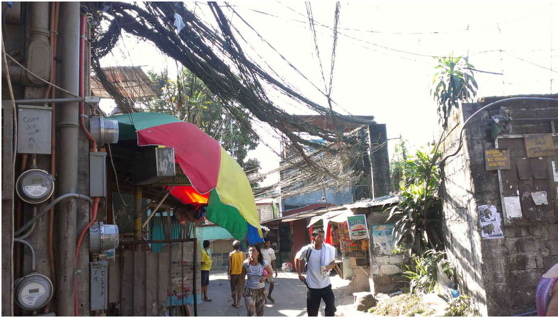
FIGURE 5.2 – Lacis de câbles électriques dans le quartier de Pansol, à Quezon City. Source : photographie personnelle (2013).
