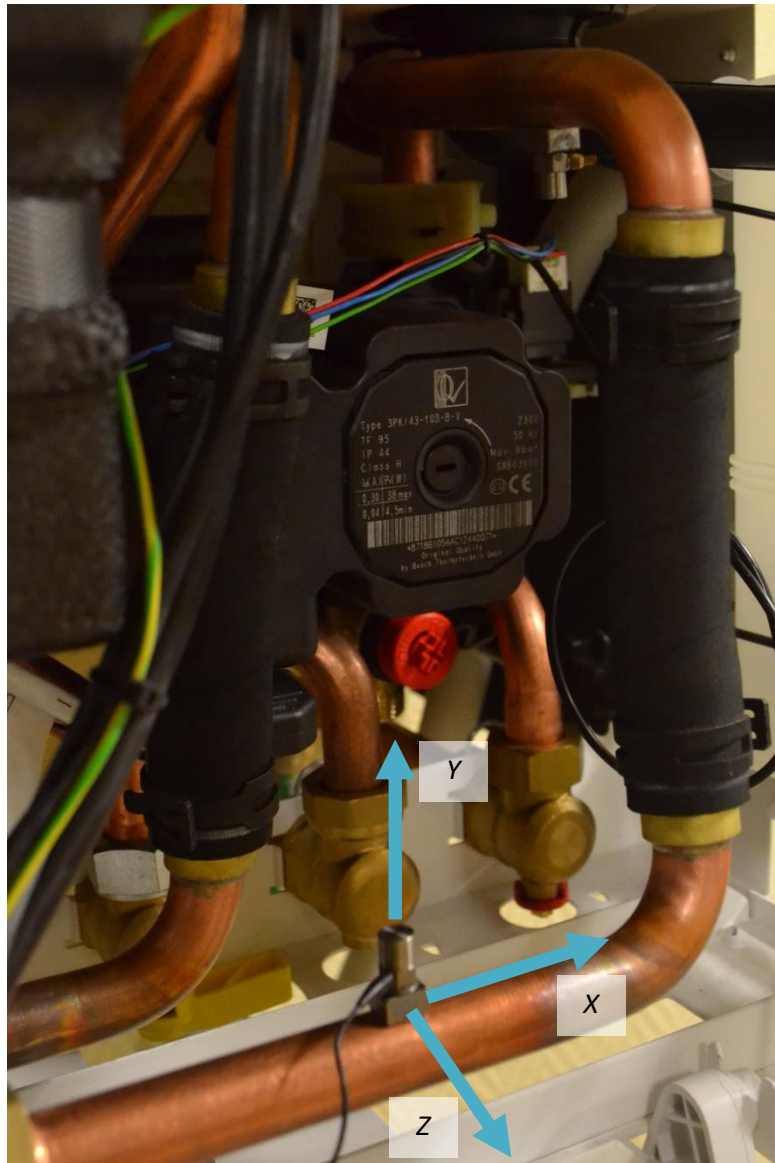
Figure 2-9 : Accéléromètre et son embase placés sur l'un des deux tubes hydrauliques reliant la pompe à chaleur à la chaudière
