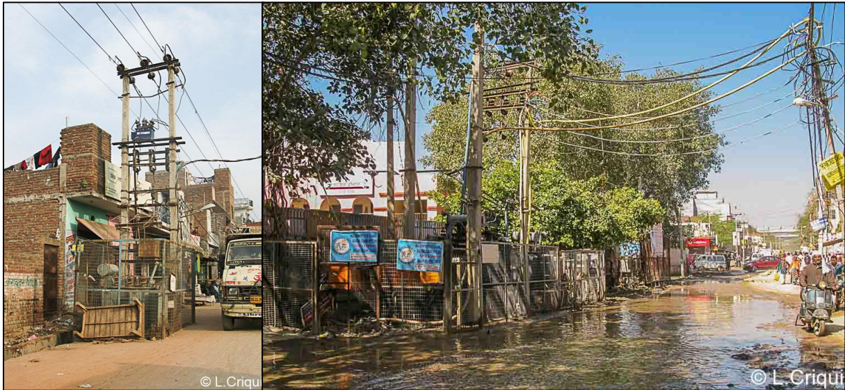
Photo 69/D. Transformateur empiétant sur la route
