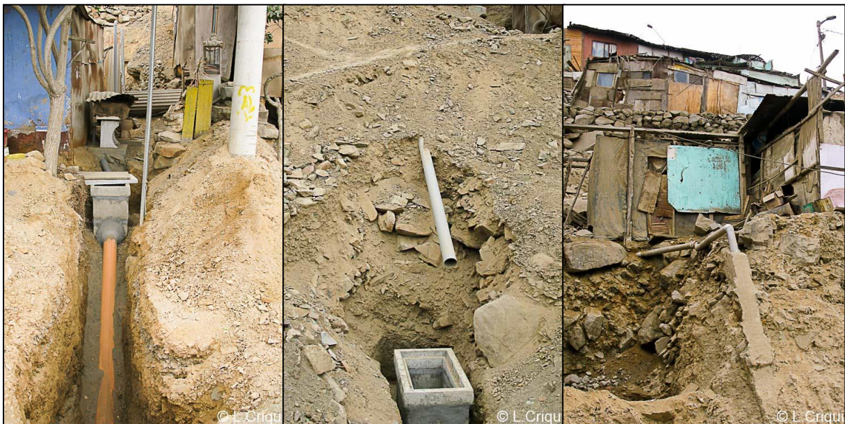
Photo 45/L. Égout condominial
