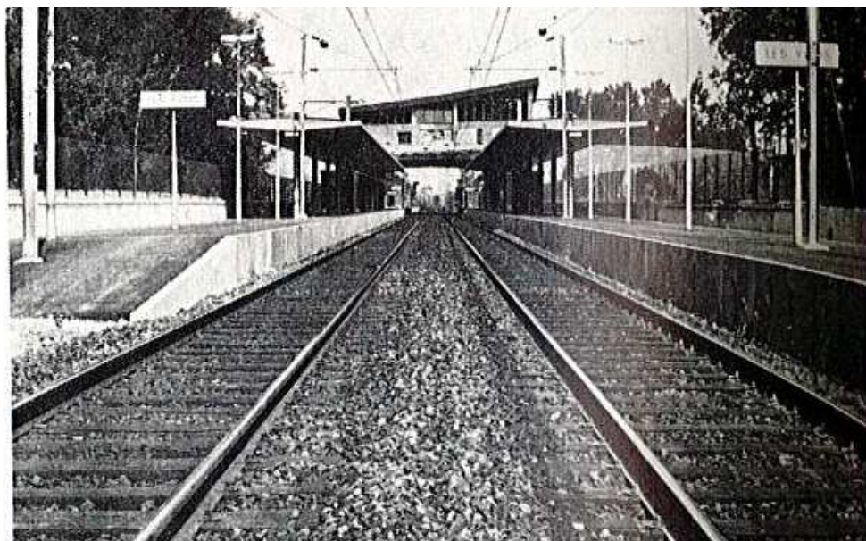
Figure 13 : « Quais : Eclairage des quais mi-haut »
