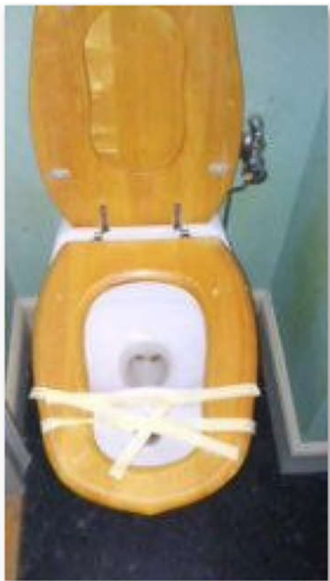
Figure 4.14 : Toilette à séparation d'urine bouchée au niveau du tuyau d'évacuation des urines.
