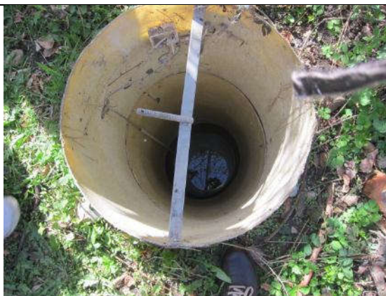
Cuve de stockage de l'urine
