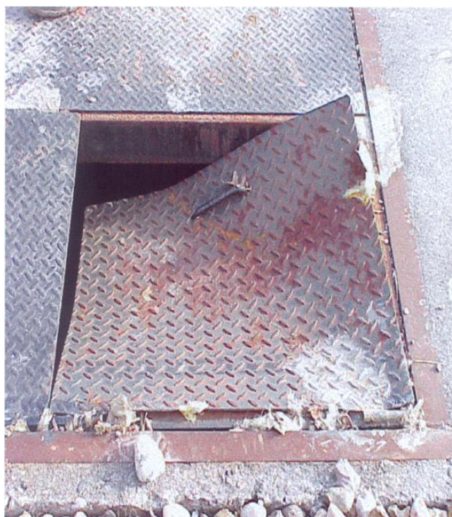
Figure 60 : Point d'entrée de l'eau dans les galeries techniques (IRSN, 2000)
