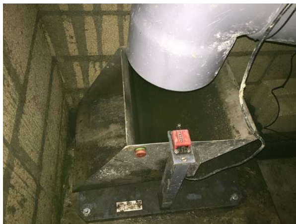
Figure 39 : Auget basculant du regard des eaux brutes
