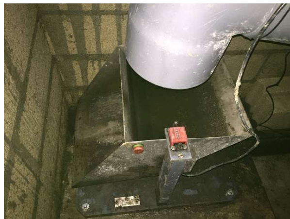
Figure 39 : Auget basculant du regard des eaux brutes
