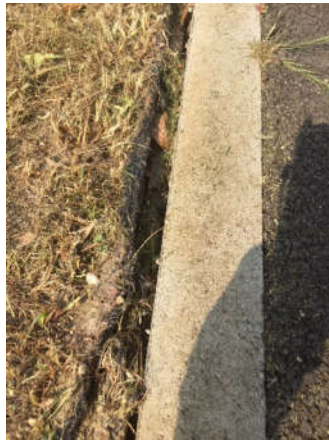
Figure 105 : Exemple de rétractation du sol à la jonction entre une noue et le bord de la chaussée à Torcy (Gromaire, 2018b)
