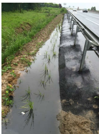
Figure 34 : La noue filtrante remplie d'eau avant la pose des redans en Mai 2016; l'eau déborde en aval de l'ouvrage, alors qu'il n'y a pas de stockage sur la partie amont.
