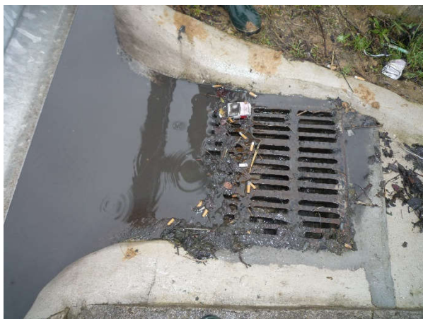
Figure 38 : Avaloir du regard des eaux brutes
