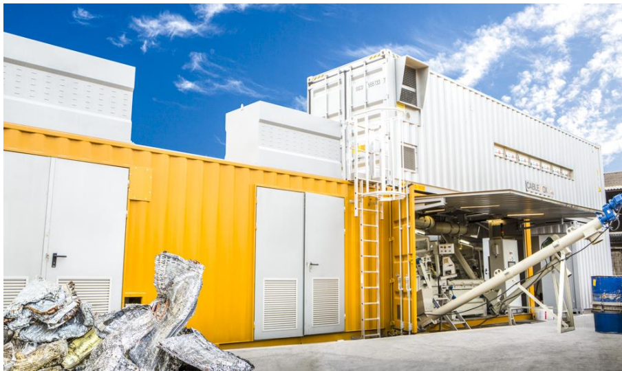
Figure 2-22 Visualisation de la solution CABLEBOX CBR2000 implantée chez MTB pour le recyclage de câbles
