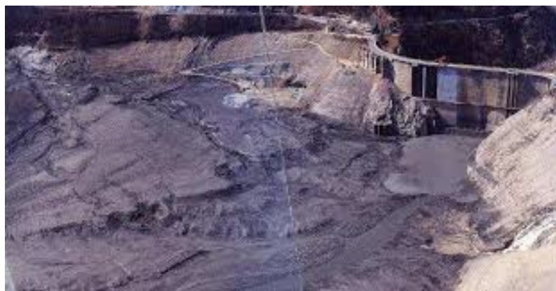
Figure 2: Exemple de vidange de retenue.
