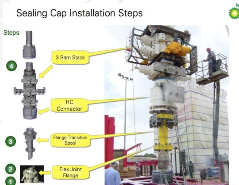
Figure 104 : le Capping stack de BP et son intermédiaire de fixation, le transition spool
