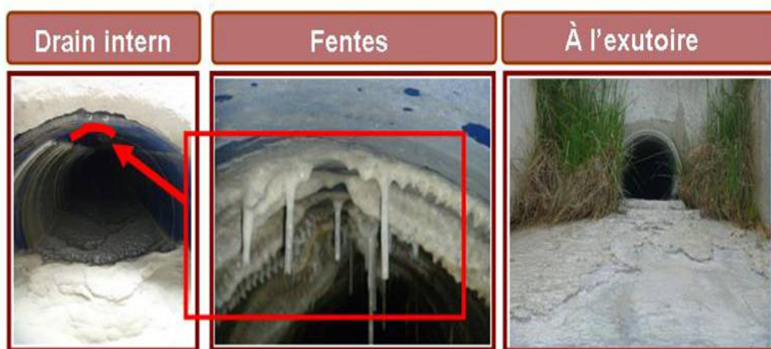
Figure 28: Etat initial du colmatage du collecteur drainant (CD_tronçon2) - Chauconin (77)- 05/2013
