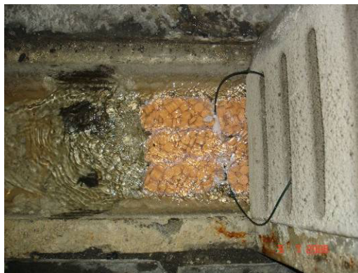
Figure 113: Sachet de pastilles dans le caniveau du tunnel de Marseille
