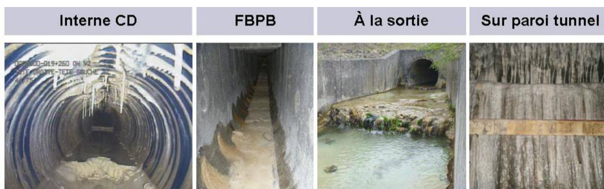
Figure 8: Concrétions calcaires constatées dans les drainages de LGV et en tunnel de ligne classique NB : Concrétions internes au collecteur drainant (CD) qui bouche les fentes et crée des micros barrages au fond du CD ; Concrétions dans une barbacane d'un fossé préfabriqué à barbacanes (FBPB) ; Concrétion dure à la sortie d'une buse de drainage le long de la voie qui crée des travertins et réduit la section mouillée du canal ; Concrétion accrochées et accumulées en draperies sur une paroi de tunnel (comme dans les milieux karstiques).
