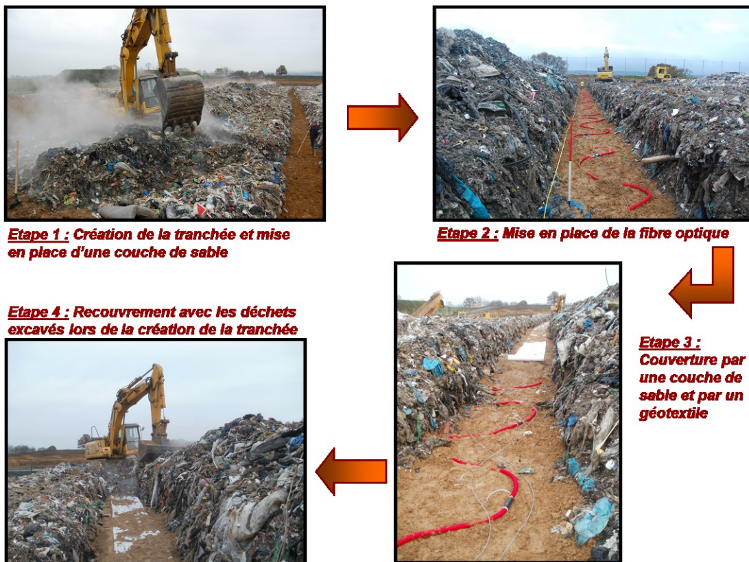
Figure 55 : Photographies de l'installation de dispositif de mesure géophysique dans le casier 4 (Grossin-Debattista et al., 2014).
