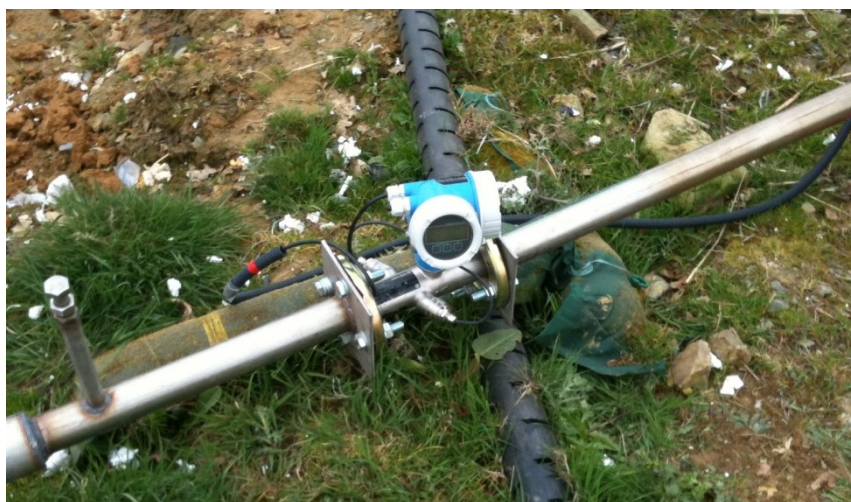
Figure 53 : Débitmètre biogaz installé sur le casier 4
