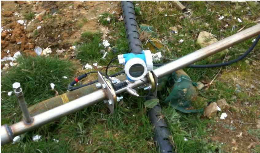
Figure 53 : Débitmètre biogaz installé sur le casier 4
