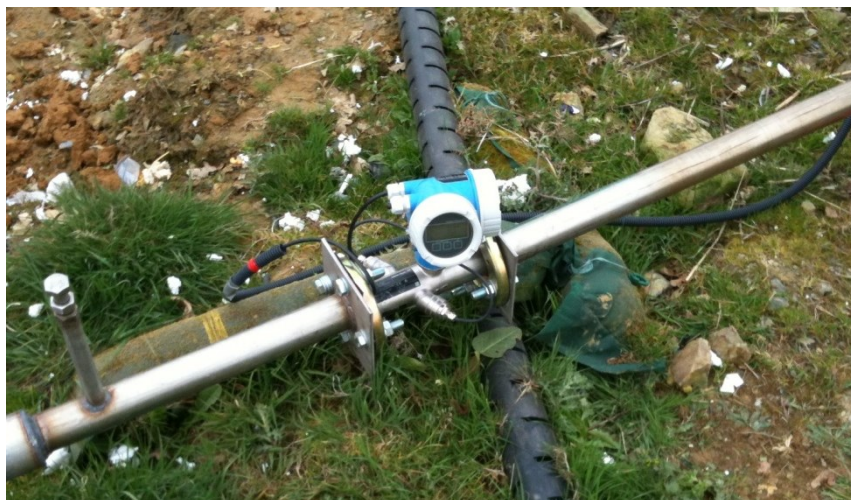
Figure 53 : Débitmètre biogaz installé sur le casier 4
