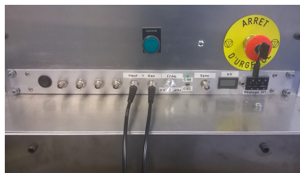
FIGURE 6.8 – Le module de commande intégré à l'armoire électrique.
