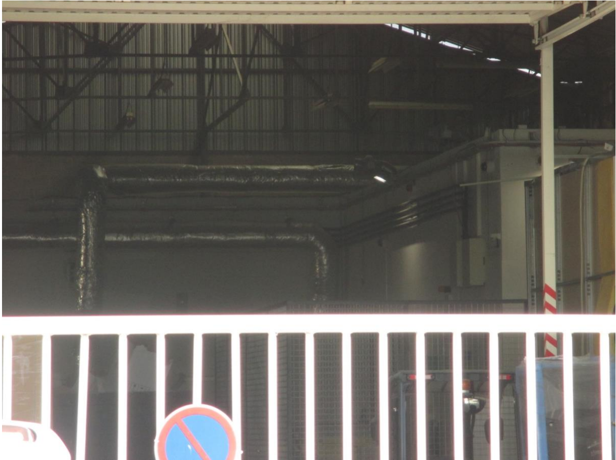
Figure 5.3. Intérieur d'un data center de l'entreprise de télécommunication GTT situé à Aubervilliers, photo prise en profitant de l'ouverture d'une porte d'accès pour les véhicules. On peut voir en blanc les salles hermétiques dans lesquelles sont entreposés les serveurs, en gris métallisés les conduites de climatisation, ainsi que deux caméras de sécurité.
