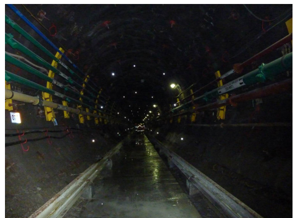
FIGURE I.17 – Photo des capteurs de déplacement dans un tunnel d'exploitation.
