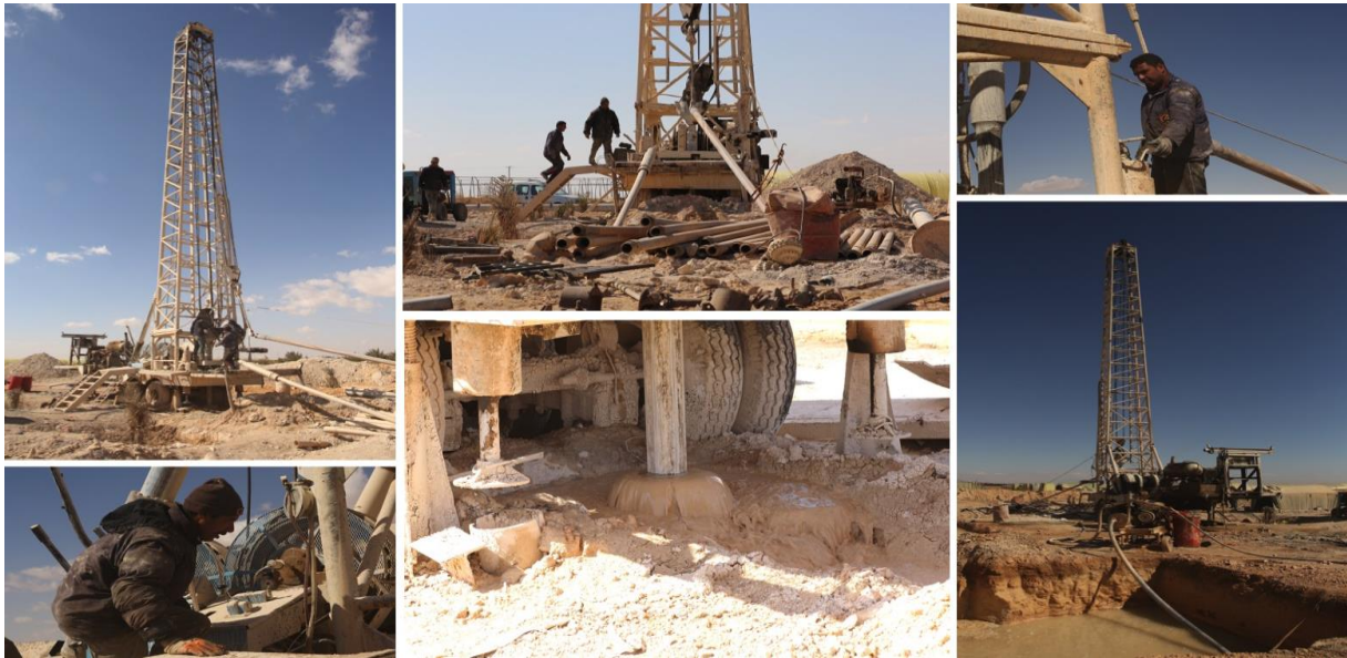
Photographie 12. Chantier de réalisation d'un forage agricole avec un dispositif de type forage pétrolier.
