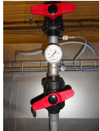
FIGURE 4.16 – Photo : vanne sur une rampe d'aspersion
