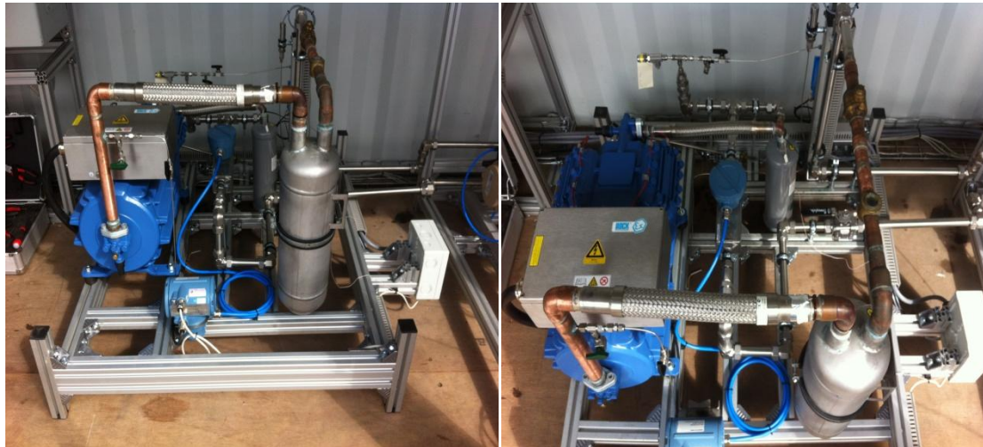
Figure 61 : Vue d'ensemble du block compresseur.
