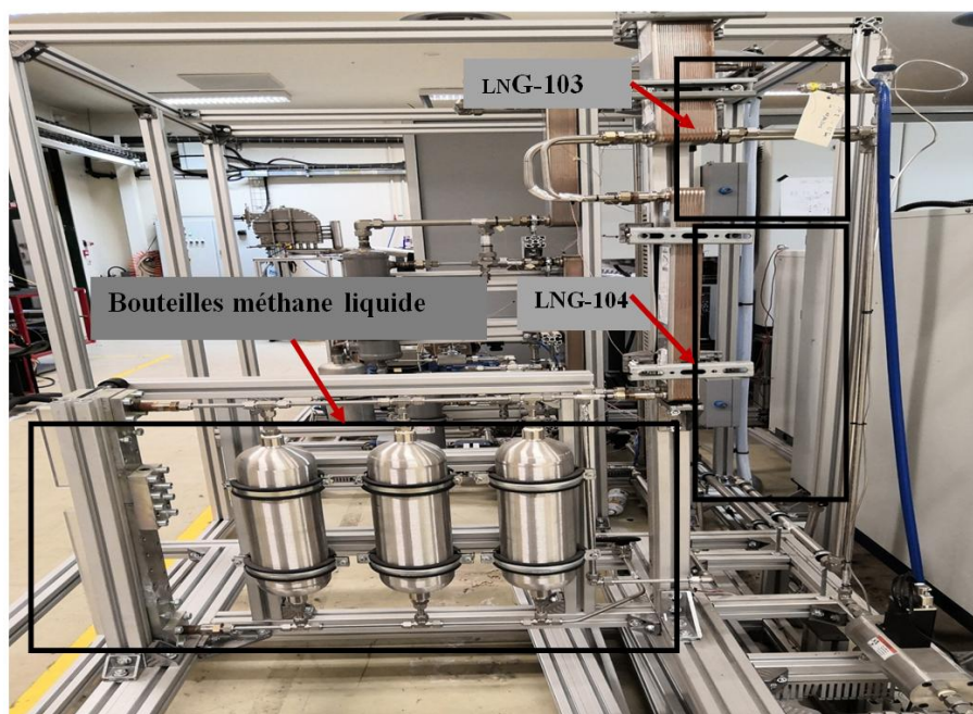
Figure 68 : Vue d'ensemble du bloc de liquéfaction du biométhane.
