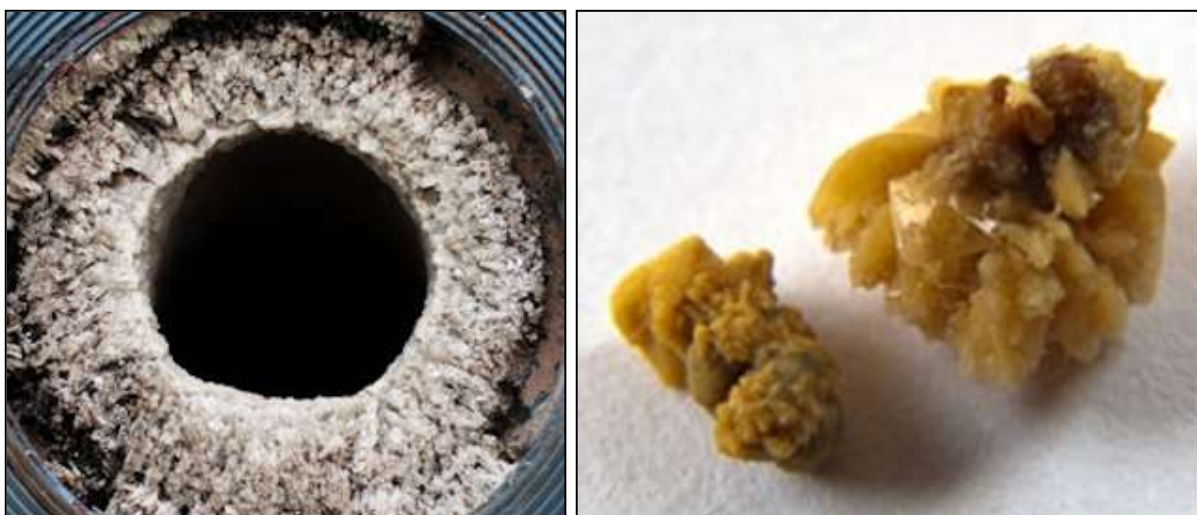
dépôt de struvite dans une canalisation
