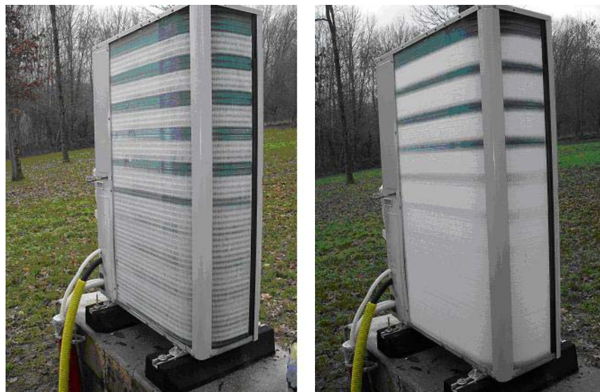
Figure 11: Exemple d'un évaporateur d'une pompe à chaleur d'un bâtiment en cours de givrage
